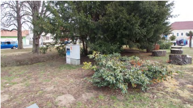
prostor před OÚ - tis, rozvodná skříň
